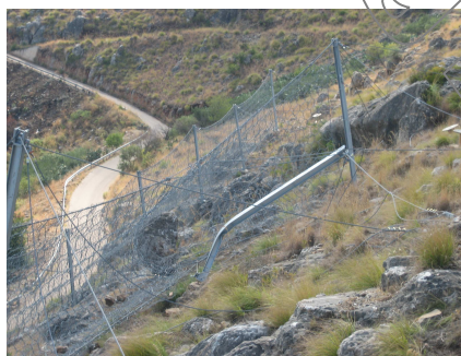
fig 4 - La realtà della caduta massi naturale ... impatto non a norma ... 1° SEL, 2° SEL, MEL, o ...?
